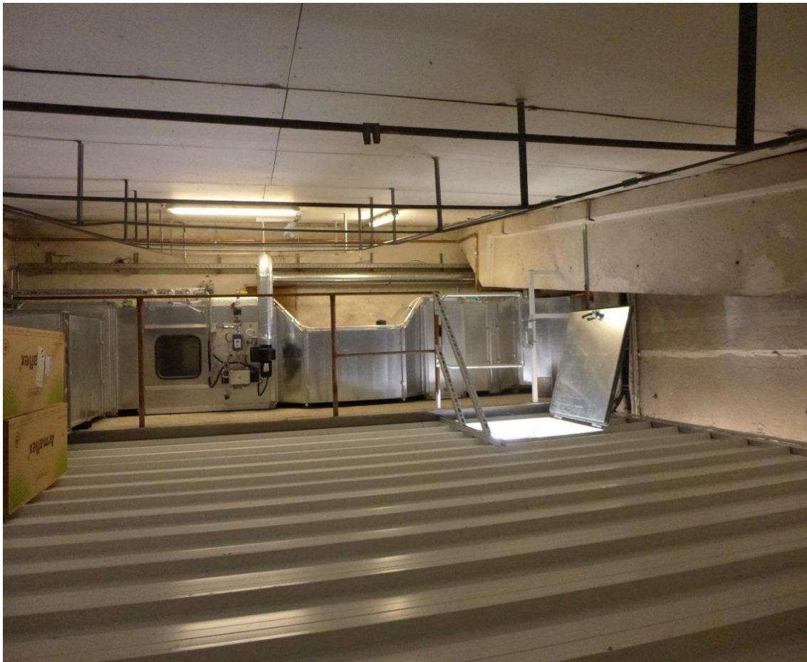
Apparatur Zuluft Vorbereitung mit GF Brenner auf Empore - mit Zwischendecke Neuzustand
