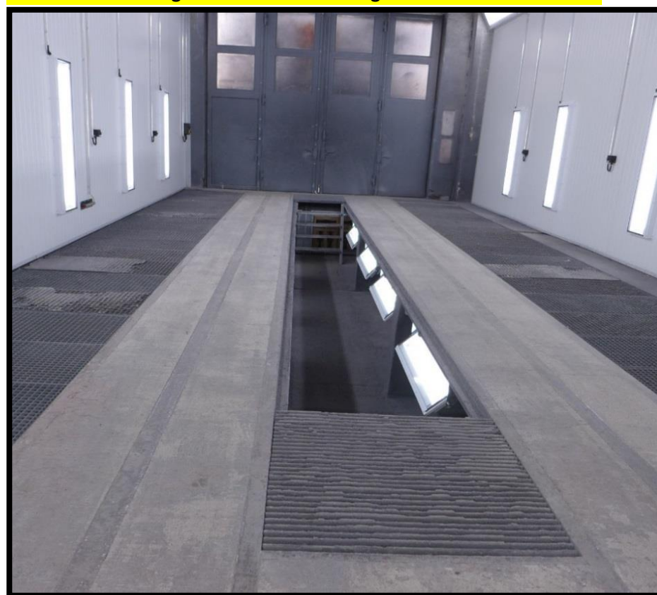
Grubenbeleuchtung neu in LED Ausführung
