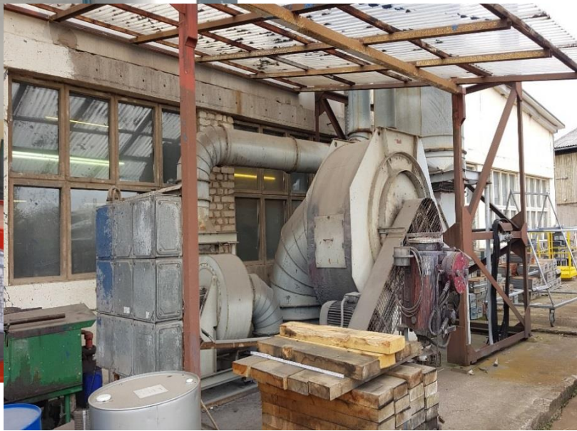
Apparatur alt Abluft
