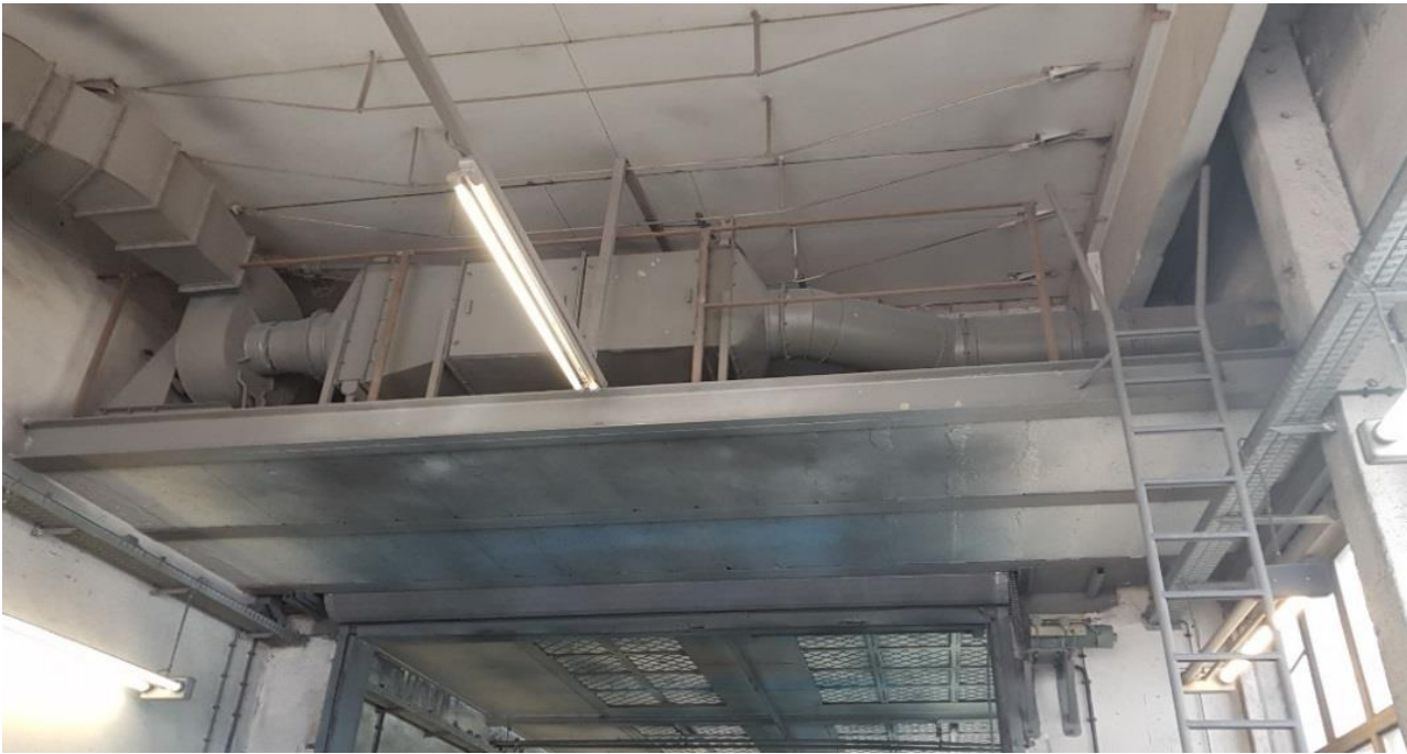
Apparatur Zuluft Vorbereitung auf Empore - ohne Zwischendecke Altzustand
