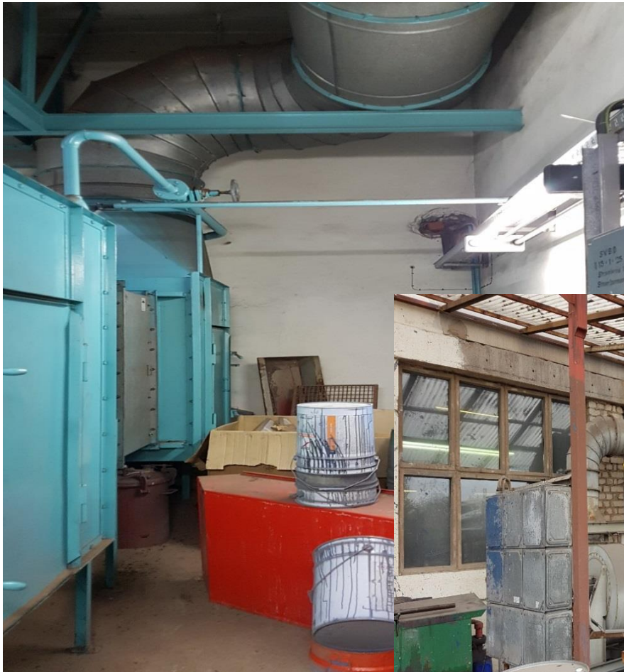
Apparatur alt Zuluft
