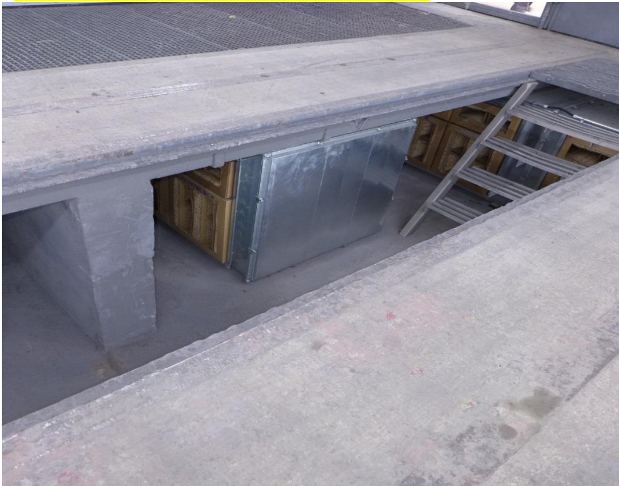
Farbabscheidung Kabine Neu mit innovativen Paint Bloc Filtern
